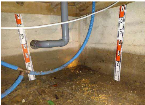
床下浸水の写真の撮り方
