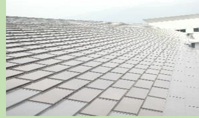
本渡中学校に設置された太陽光パネル
