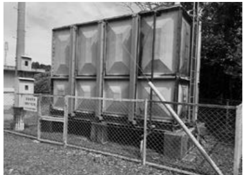
▲地域で管理する小規模水道施設
