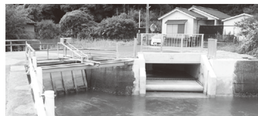
▲茂串地区の小和田川に整備された浮体式ゲート
