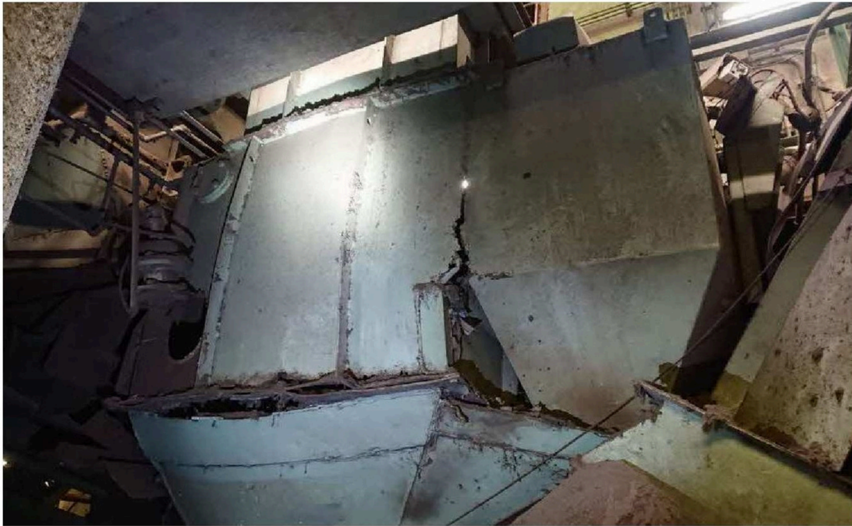
破砕機シュート部の損壊
