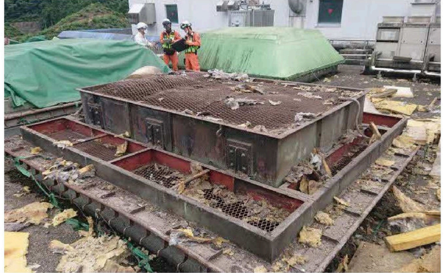
爆風口被災(屋上)
