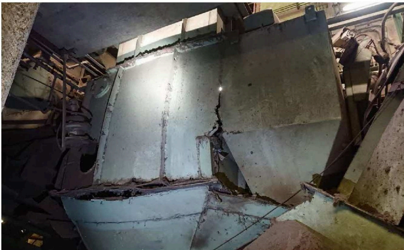
破砕機シュート部の損壊
