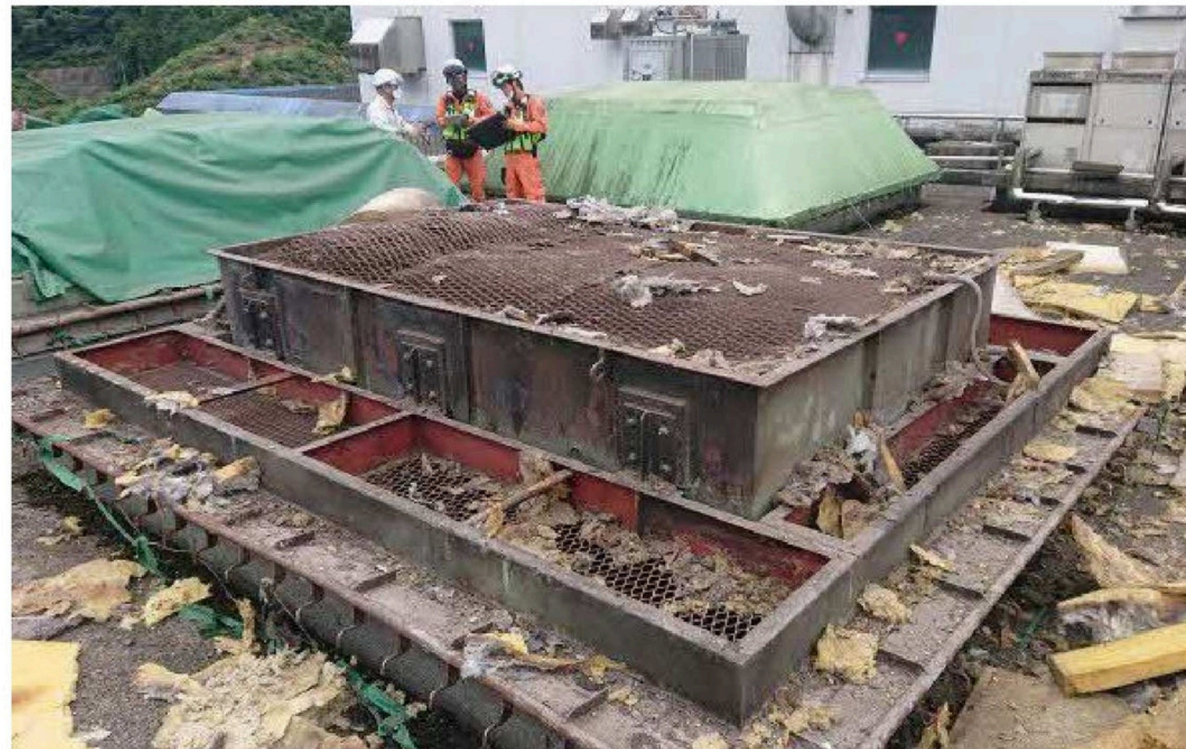
爆風口被災(屋上)
