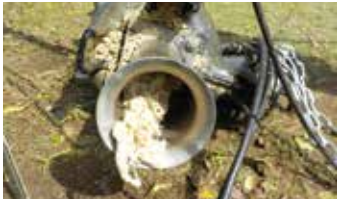
▲マンホールポンプに詰まった布のようなもの
