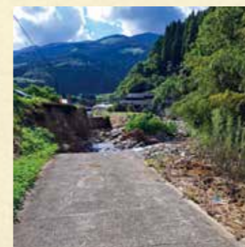
▲崩落した家の前の道路
