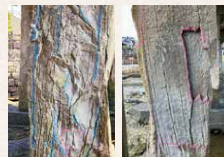
▲石材の欠損や亀裂
