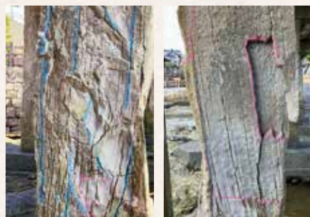
▲石材の欠損や亀裂
