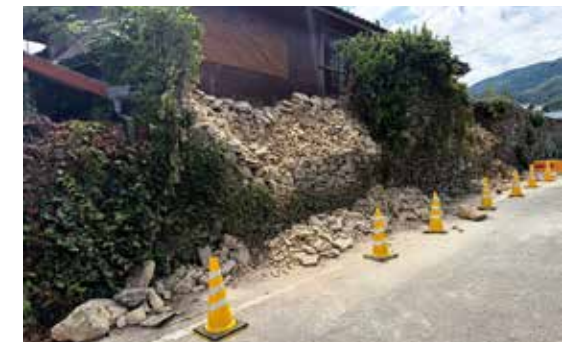
▲防風石垣の被災状況
