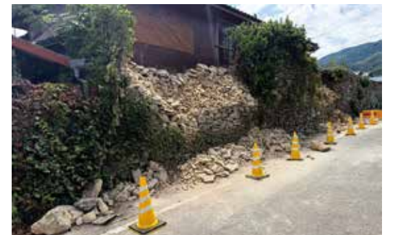
▲防風石垣の被災状況
