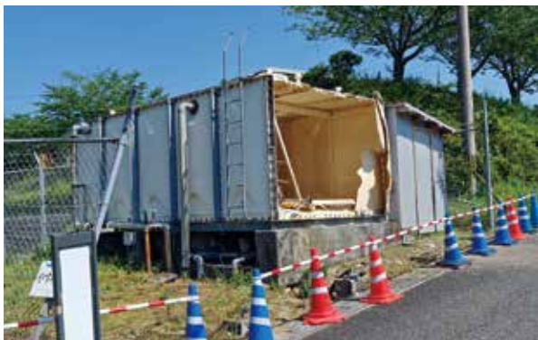
▲牛深温泉センターやすらぎの湯の貯湯タンク破損状況
