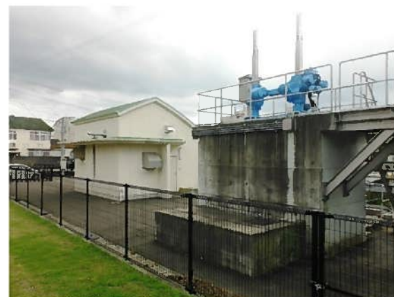
大川尻雨水ポンプ場
