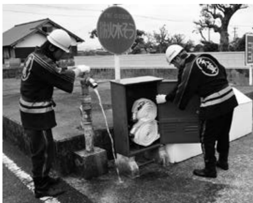
▲消防団員による消火栓の点検
