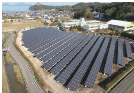
▲設置された2,616枚の太陽光パネル
