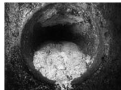
▲詰まった下水道
