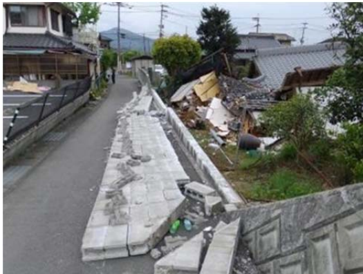
図 ブロック塀の倒壊
