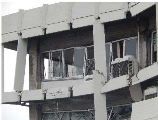
図 庁舎棟の局部崩壊
