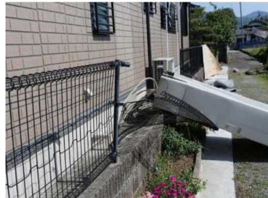
図 給湯施設の転倒
