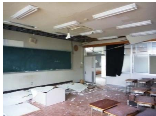
図 天井の脱落（校舎） (写真：熊本県教育委員会)
