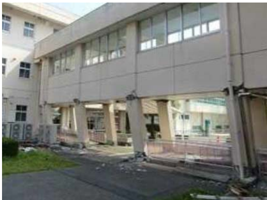
図 渡り廊下の倒壊（校舎）
