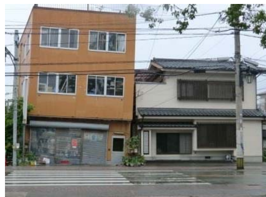
図 液状化による建築物の傾斜
