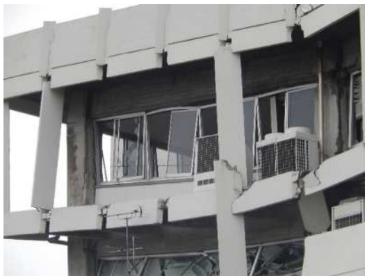
図 庁舎棟の局部崩壊
