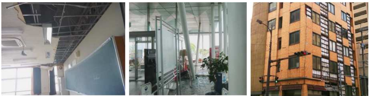
非構造部材の被害（天井・窓ガラス・外壁）（写真：熊本県）
