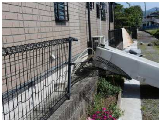
図 給湯施設の転倒
