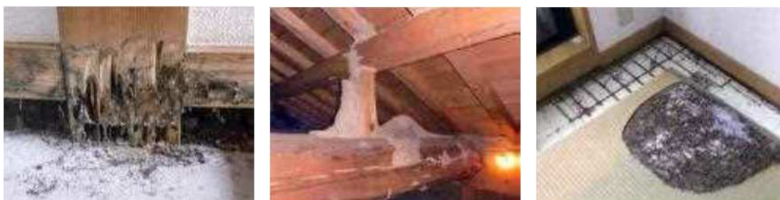
シロアリによる被害（柱脚・小屋裏・畳）（写真：国土交通省）
