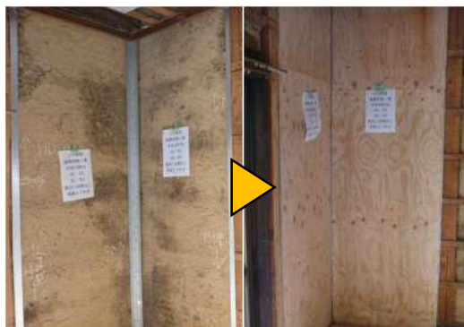
天井、床を解体せずに壁を補強する低コストの改修例 (写真：半田市)
