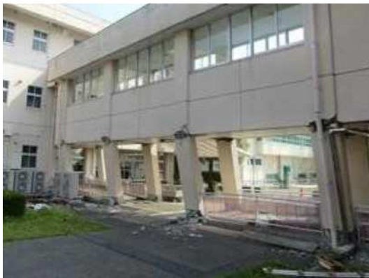
図 渡り廊下の倒壊（校舎）
