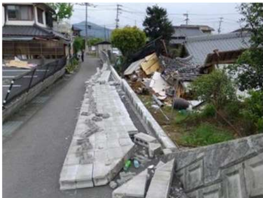
図 ブロック塀の倒壊
