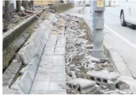
画像 ブロック塀の被害 (資料：国土交通省)
