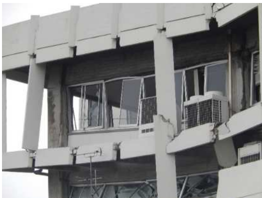
図 庁舎棟の局部崩壊
