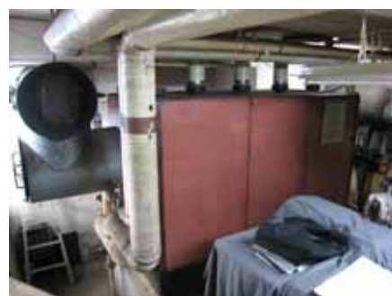
老朽化したボイラー設備 (設置後47年経過)
