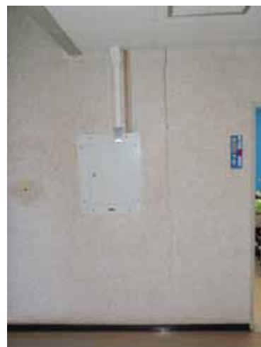
* ひび割れが入った壁 (本館2階)
