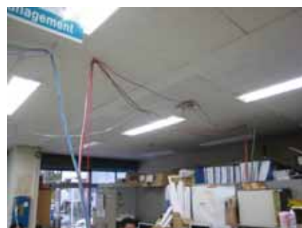
天井から下がっている LAN ケーブルや電源コード
