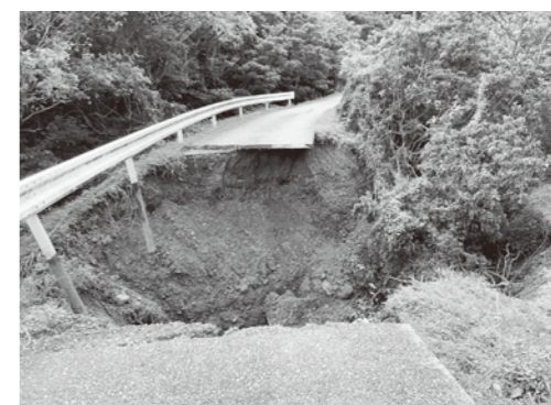
▲魚貫町の陥没した道路
