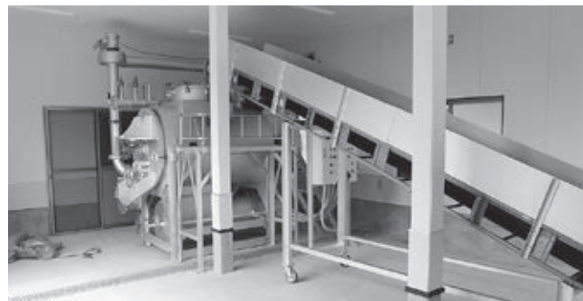
▲イノシシを減容化处理する設備
