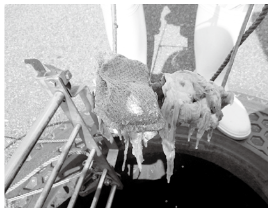
▲マンホールポンプに詰まっていた食器用スポンジなど
