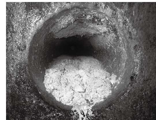
▲油の固まりで詰まった排水管
