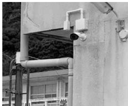
▲亀川小学校に設置の防犯カメラ
