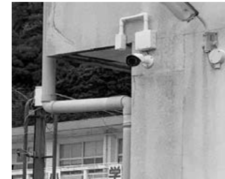
▲亀川小学校に設置の防犯カメラ
