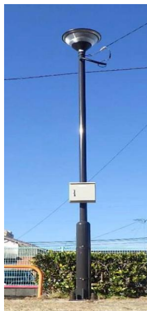
東町公園のLED照明
