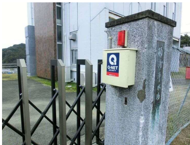
写真 2-6-1 不法侵入を防止する警報装置
