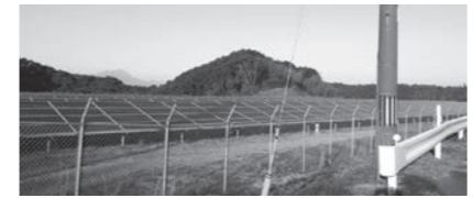
▲事業者が設置した太陽光発電設備
