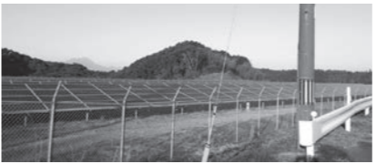
▲事業者が設置した太陽光発電設備
